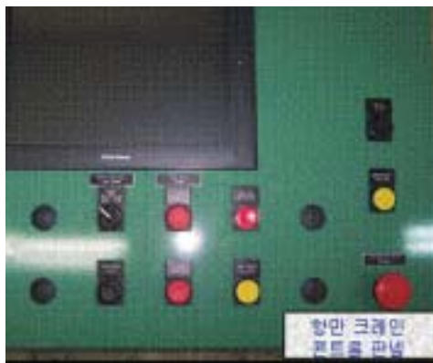
항만 크레인 콘트롤 패널
