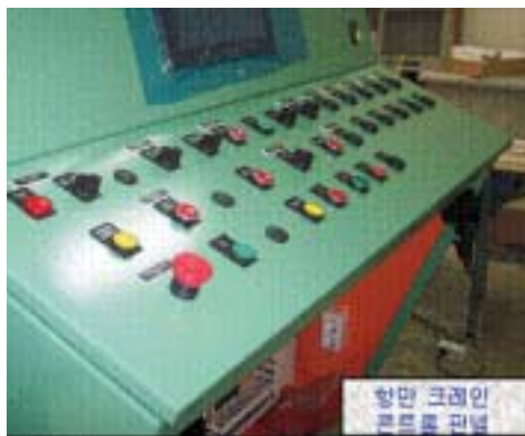
항만 크레인 콘트롤 패널
